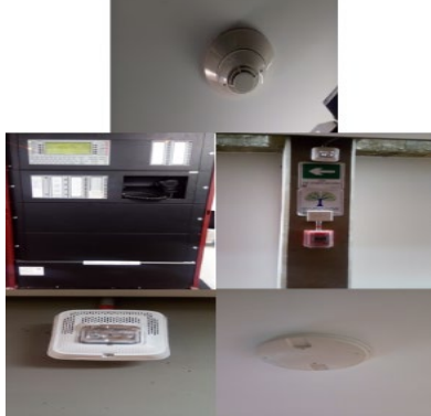
Ilustración 134. Componentes sistema detección de incendio
